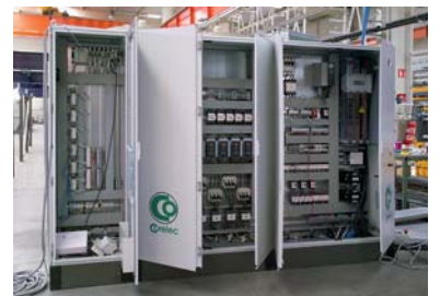
Armoire électrique Power unit
